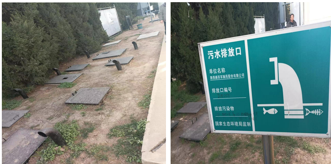
图 3-3 污水处理站照片
