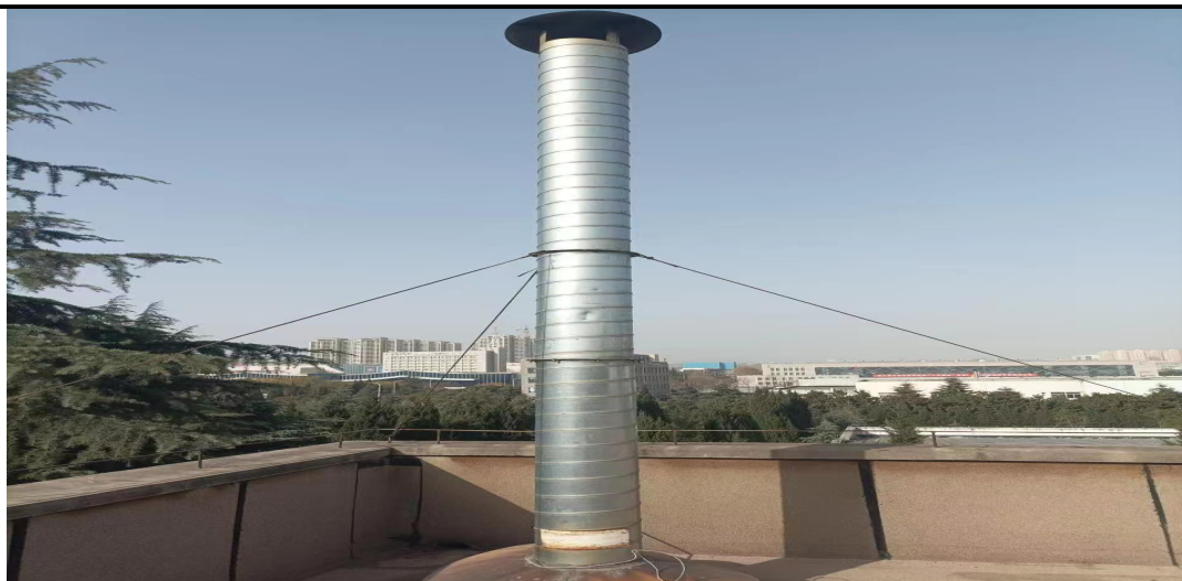
前处理车间颗粒物 DA001 排气筒
